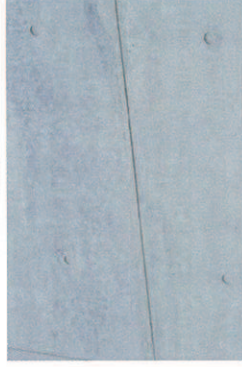
Bild G.3. Abdruck Schalungssstoß Träger-schalung Figure G.3 Imprint element joint timber beam formwork
