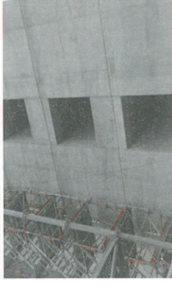
Bild G.4. Abdrücke Arbeitsfugen mit Trapezleisten Figure G.4. Imprints construction joints with ledges
